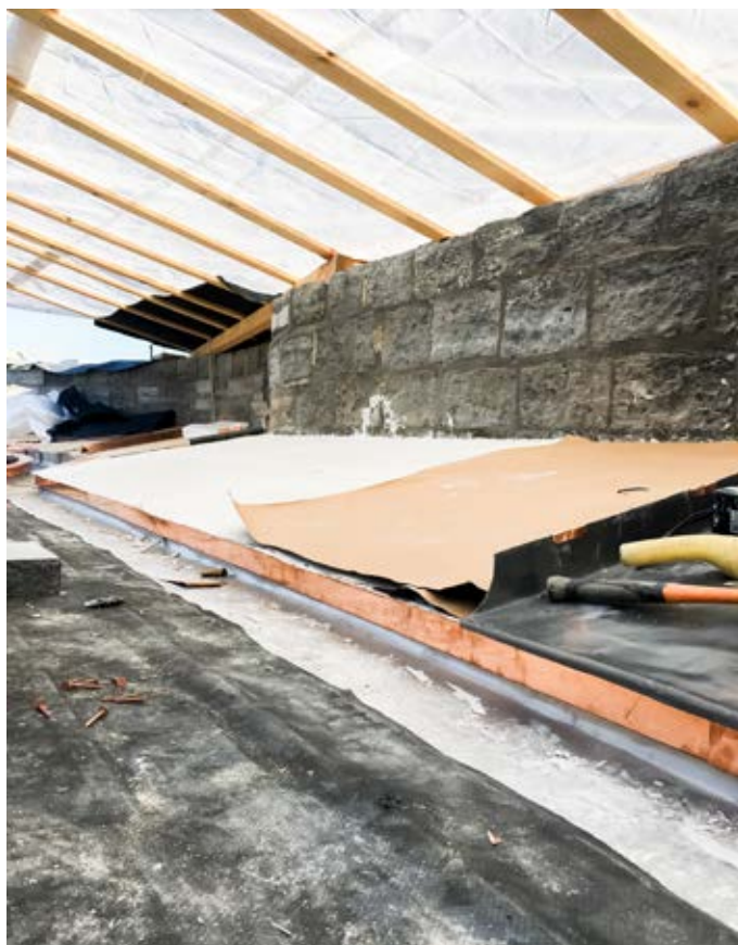
Vue d'ensemble de la préparation du support : plâtre + membrane de désolidarisation. © SPW-AW&P
